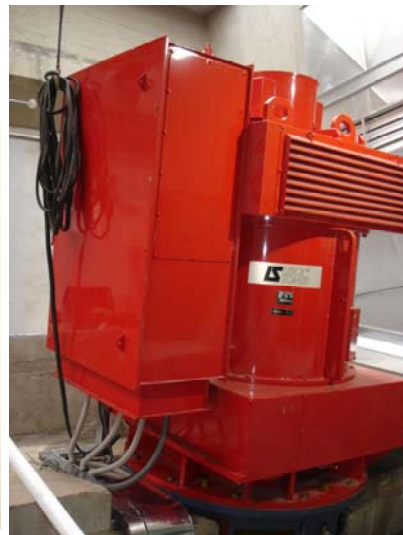
Γεννήτρια Leroy Sommer
