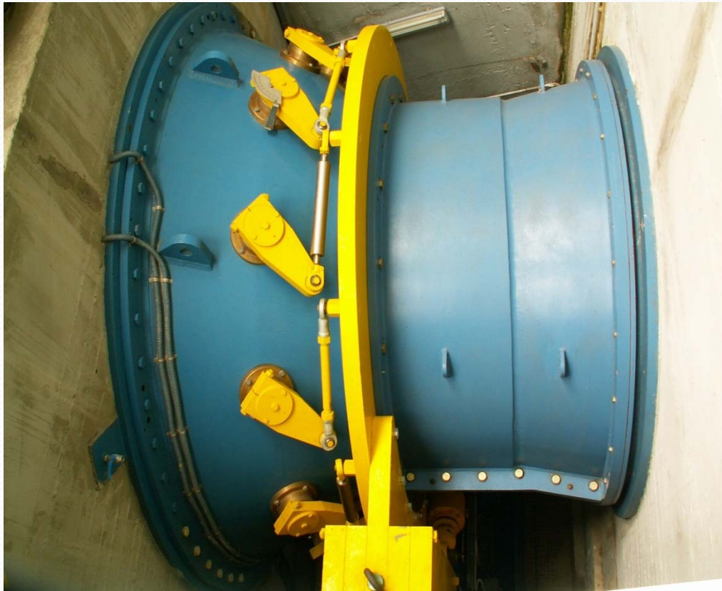
Στρόβιλος Vatech Andritz Hydro
