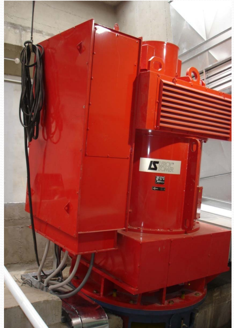
Γεννήτρια Leroy Sommer
