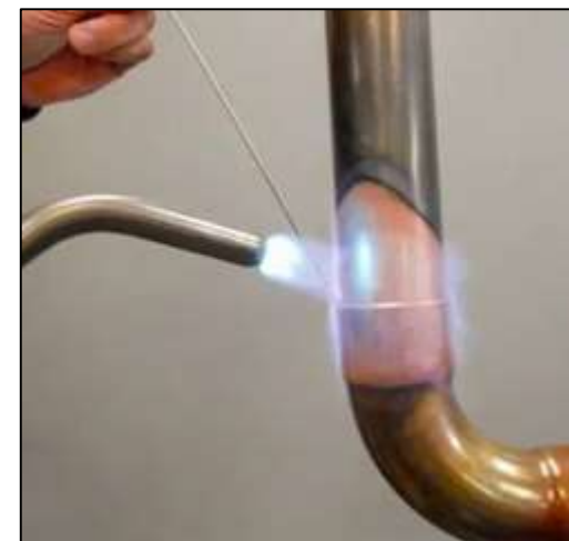
Σύνδεση με σκληρή κόλληση
