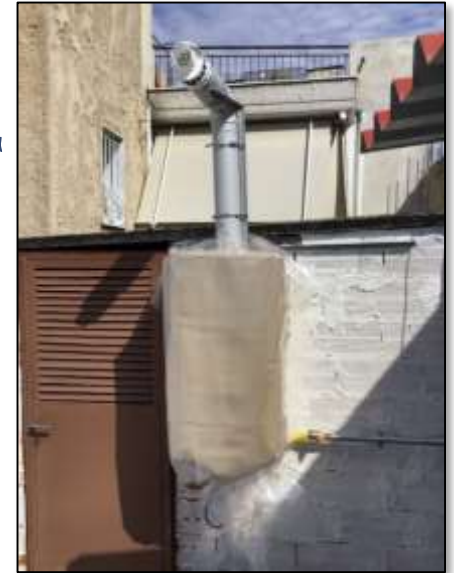
Τοποθέτηση λέβητα σε άγνωστης δομικής ποιότητας κτίσμα
